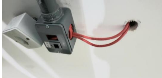
Figura 32 – Passagem improvisada do cabeamento.
