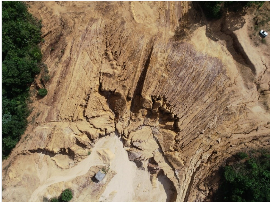
Figura 12 - Imagem da área afetada pelo desmonte hidráulico e escoamento superficial da água.
