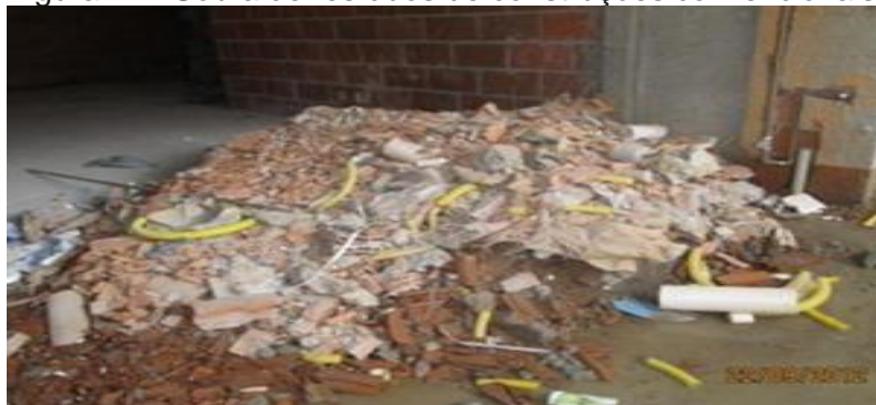
Figura 11 - Sobra de resíduos de construções convencionais
