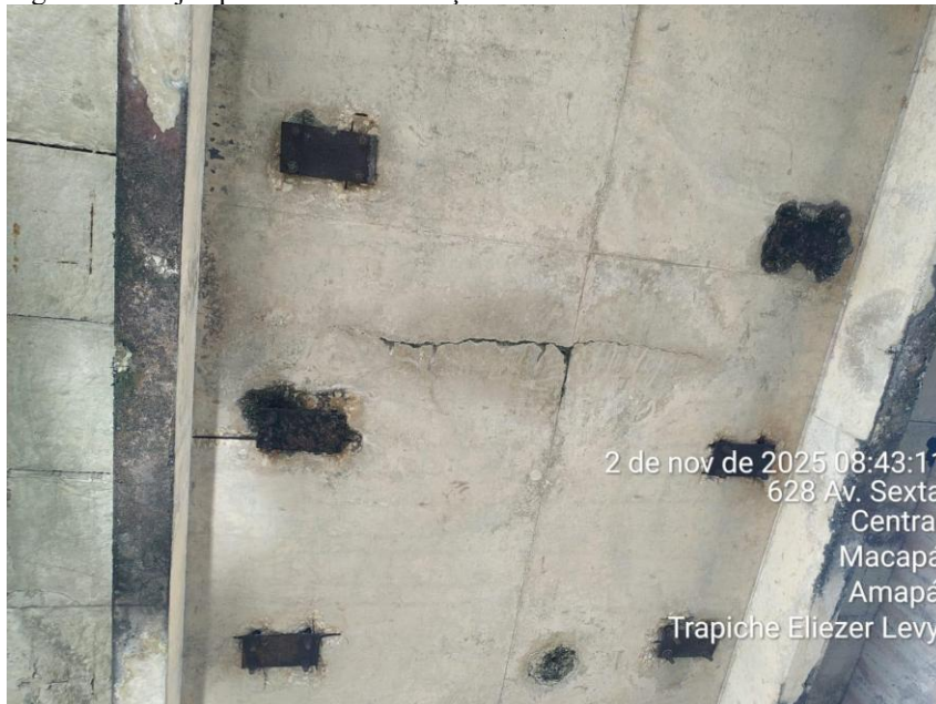
Figura 18 - Laje apresentando infiltração e fissuras
