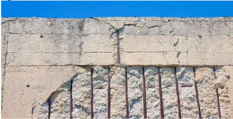
Figura 6 - Corrosão em armaduras em estruturas
