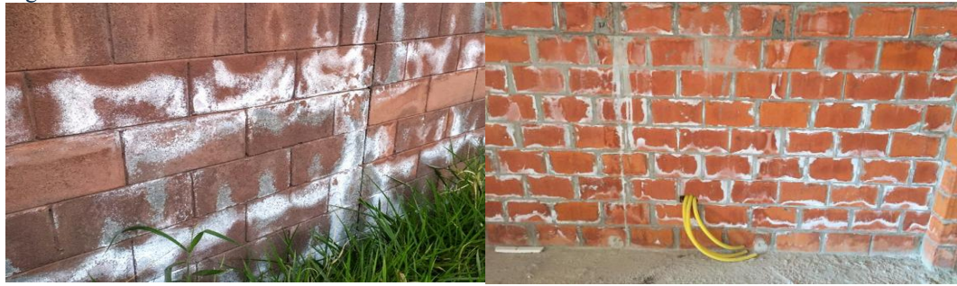
Figura 8 - Eflorescências em bloco cerâmico
