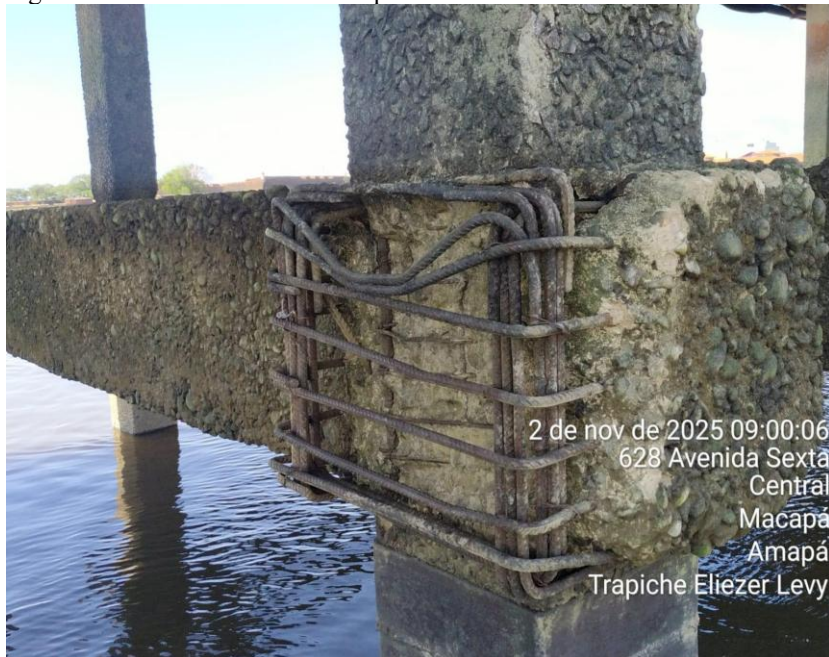
Figura 15- Processo de erosão em pilar
