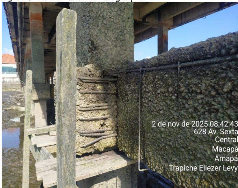
Figura 16 - Processo de erosão em viga e pilar
