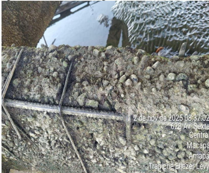
Figura 14 - Processo de erosão em viga
