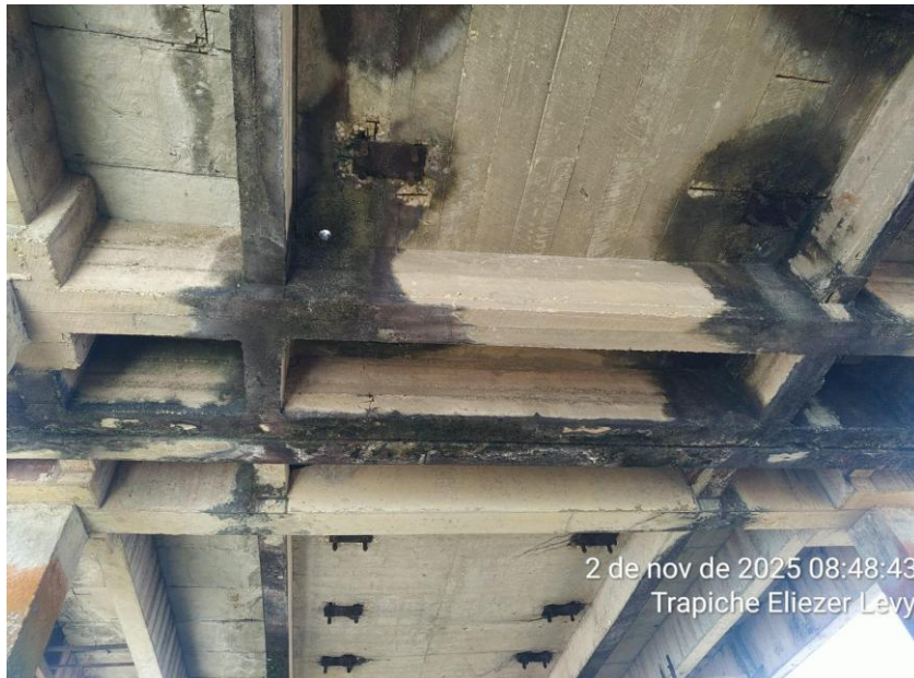
Figura 17 - Laje apresentando infiltrações
