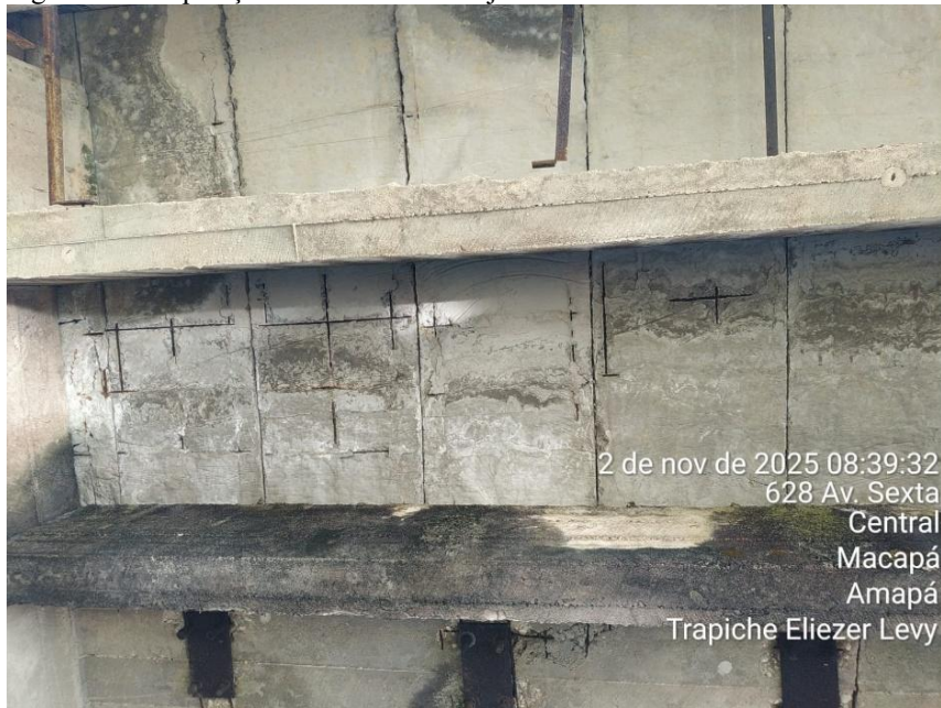
Figura 19 – Exposição da armadura da laje
