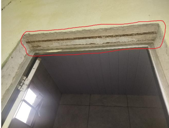
Figura 50 – Ferragem exposta na região da verga na porta do banheiro.
