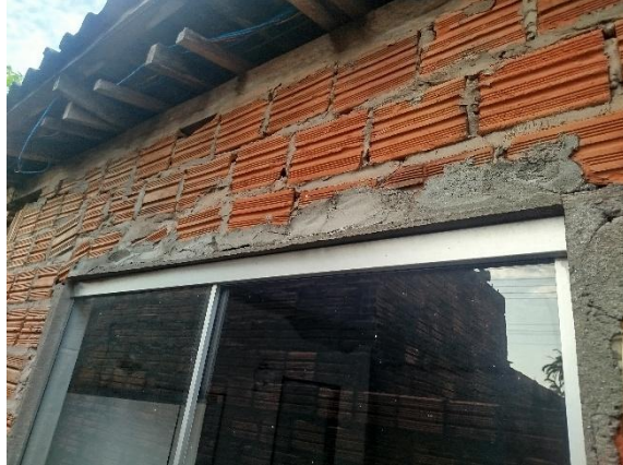
Figura 46 – Ausência evidente de verga na esquadria da cozinha.
