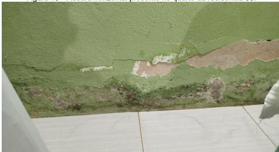
Figura 19 - Fissura horizontal presente no quarto da residência 08.
