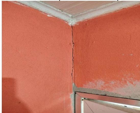
Figura 47 – Rachadura vertical iniciando a partir do vértice esquerdo da porta da área externa.
