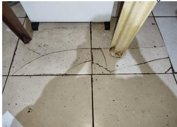
Figura 48 – Piso cerâmico totalmente fissurado na região da cozinha.
