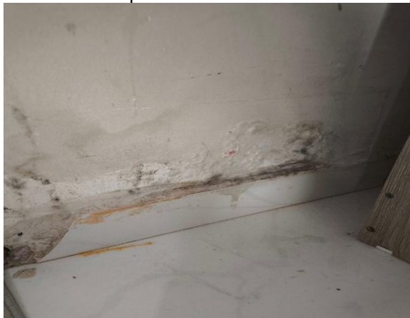
Figura 39 – Pintura próxima ao rodapé deteriorada devido a umidade presente no banheiro.
