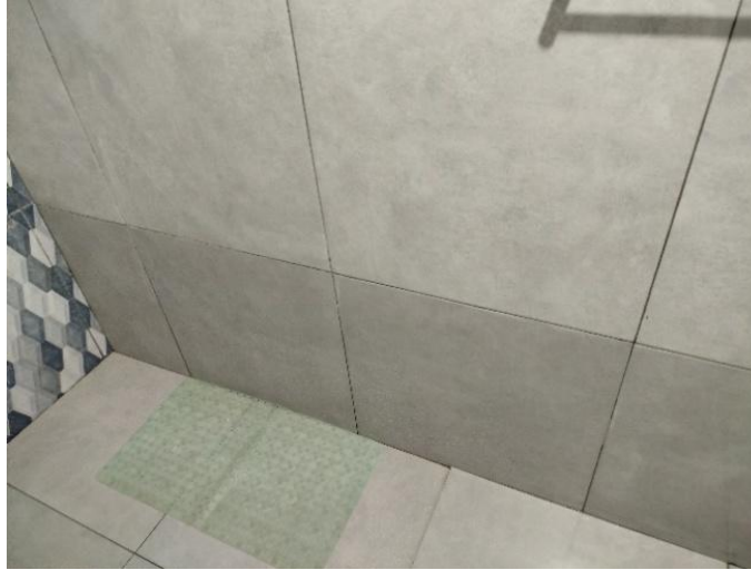
Figura 25 - Revestimento cerâmico do banheiro infiltrado na residência 08.
