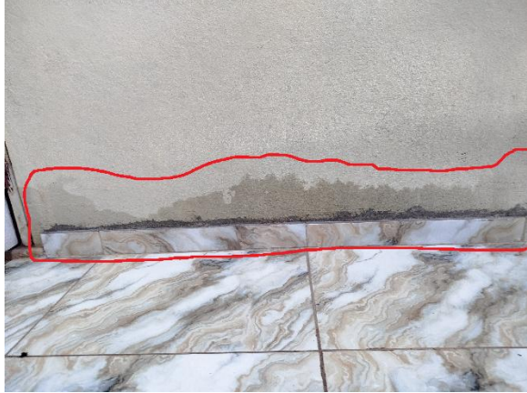
Figura 49 – Região da área externa com presença de umidade por ascensão.
