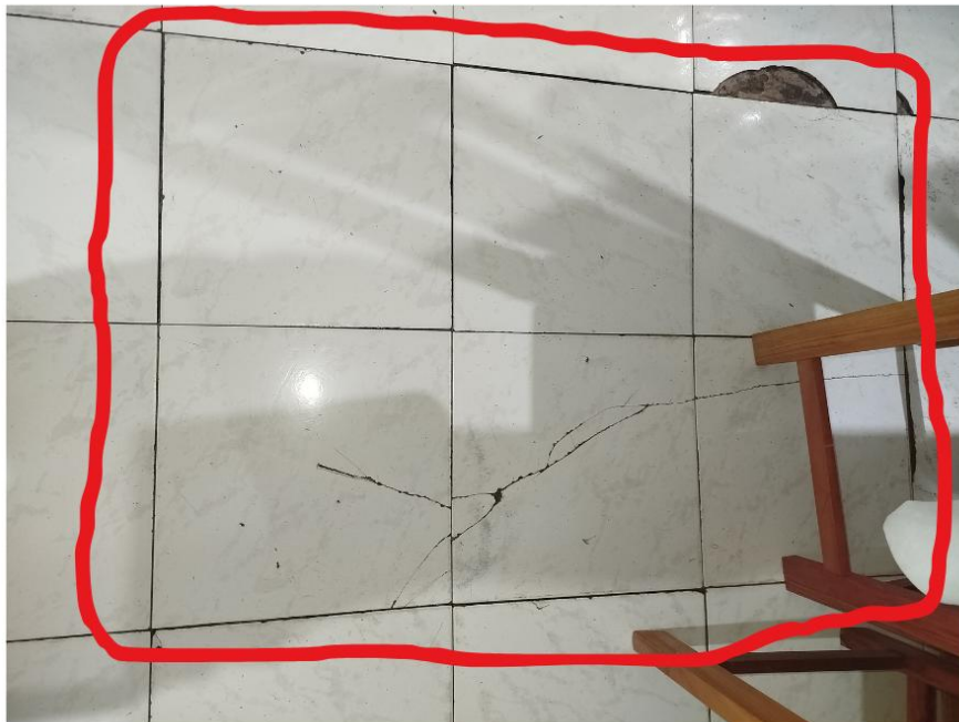
Figura 22 - Piso da cozinha localizado na residência 08.
