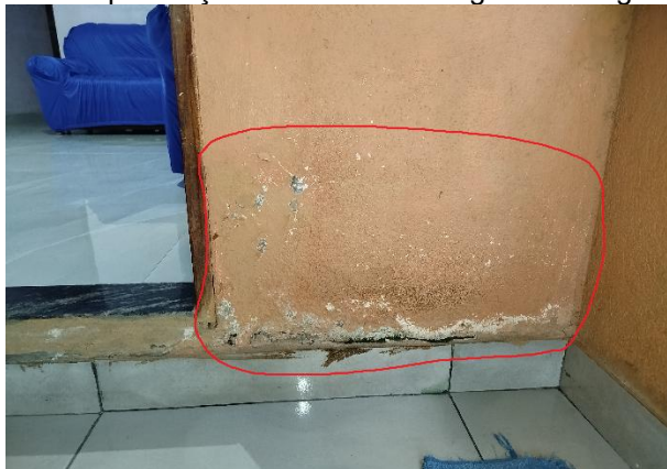
Figura 51 – Pintura com presença de umidade e desgaste na região da sala de estar.
