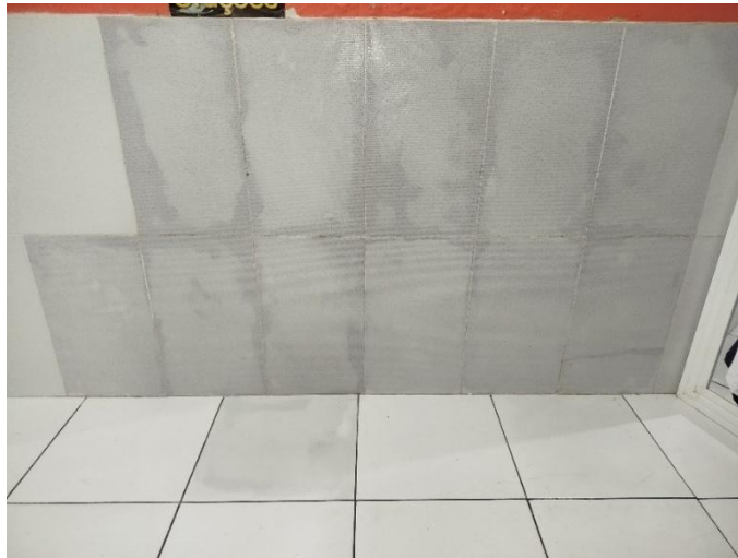
Figura 26 - Revestimento cerâmico da alvenaria que divide a área interna com externa infiltrado na residência 06.
