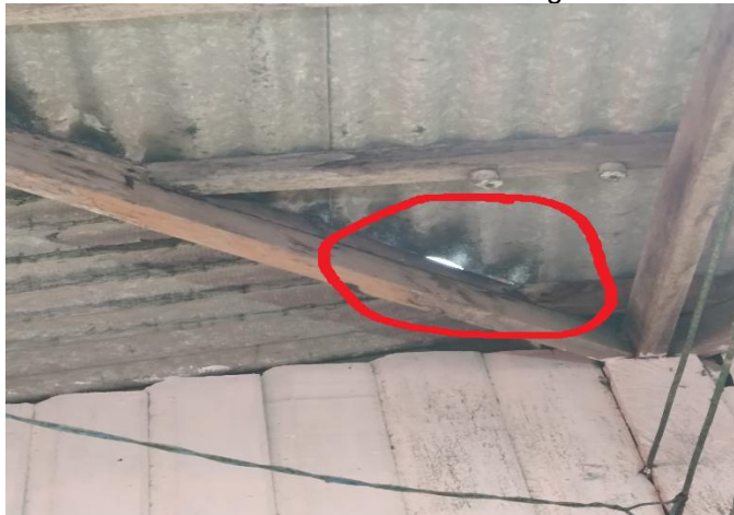
Figura 36 – Falha no telhado da cobertura na região da área externa.
