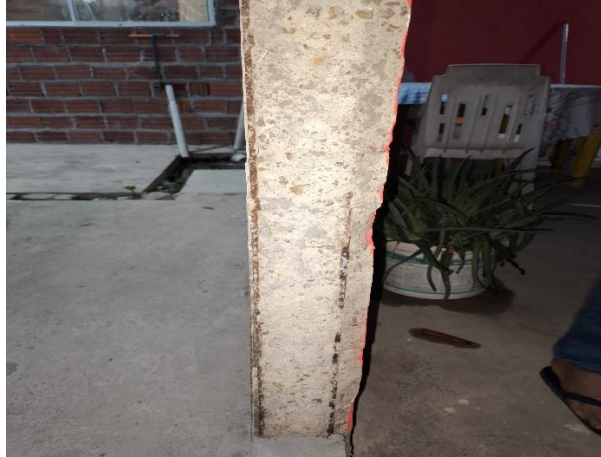
Figura 37 – Ferragem exposta a intempéries na área externa.
