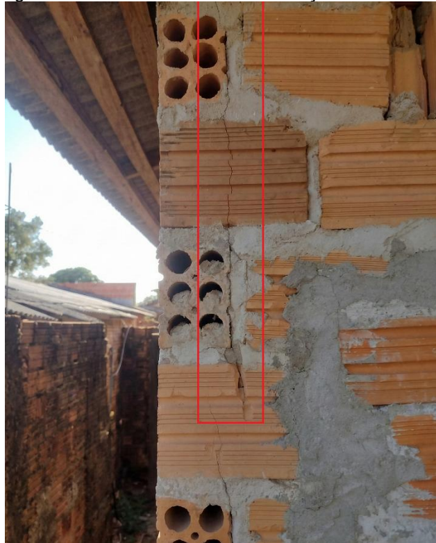
Figura 21 - Fissura vertical na amarração da alvenaria.
