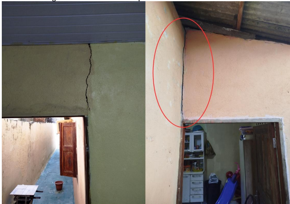
Figura 20 - Rachadura na porta da cozinha residência 08.
