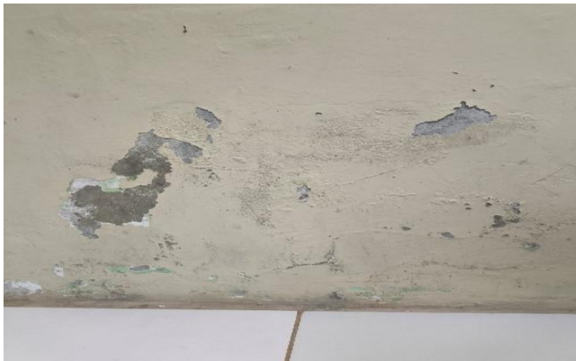
Figura 28 - Degradação da pintura e a presença de manchas na região da cozinha presente na residência 05.
