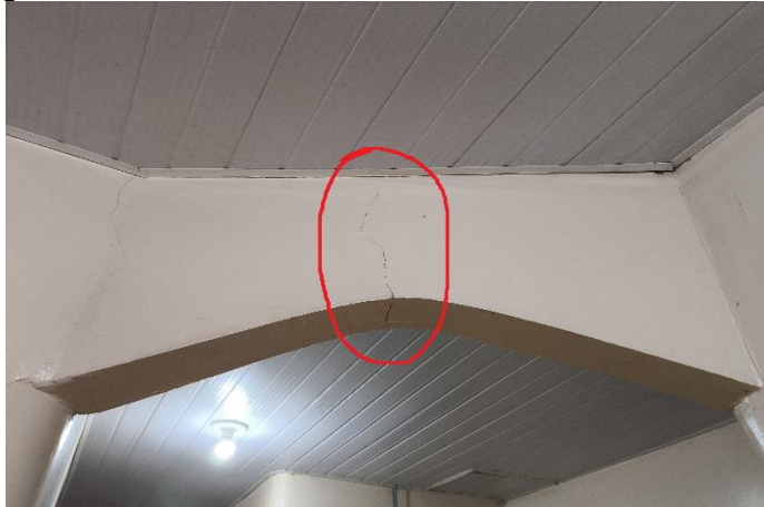
Figura 35 – Trinca horizontal no meio do arco da sala de estar.
