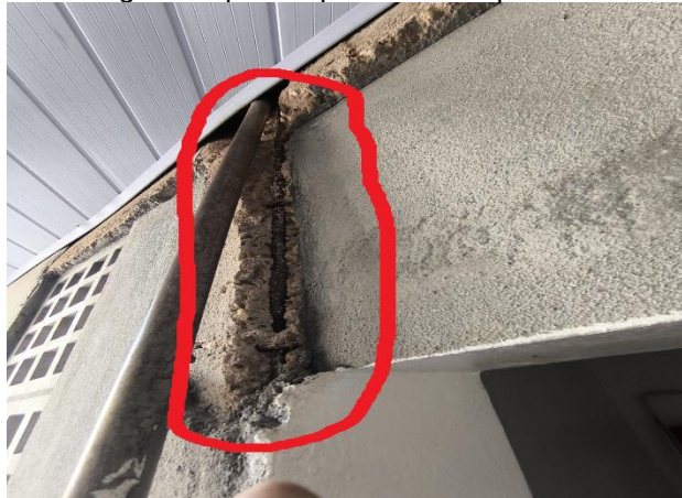
Figura 41 - Ferragem do pilar exposta a intempéries na área externa.
