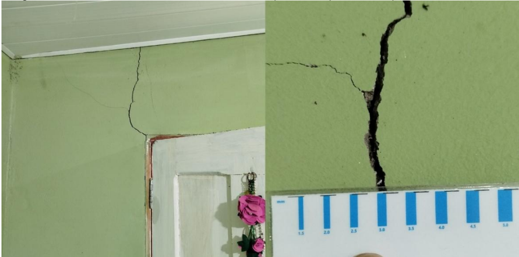
Figura 16 – Porta com rachadura no canto superior esquerdo do quarto, residência 08.
