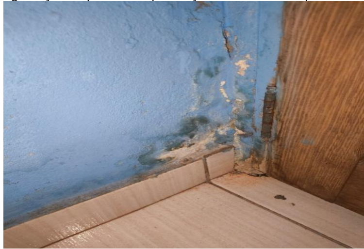
Figura 27- Degradação da pintura e a presença de manchas no quarto da residência 01.
