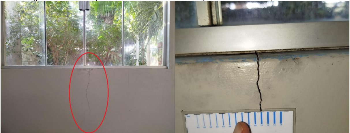
Figura 18 - Janela apresentando fissura vertical na parte inferior central, residência 06.
