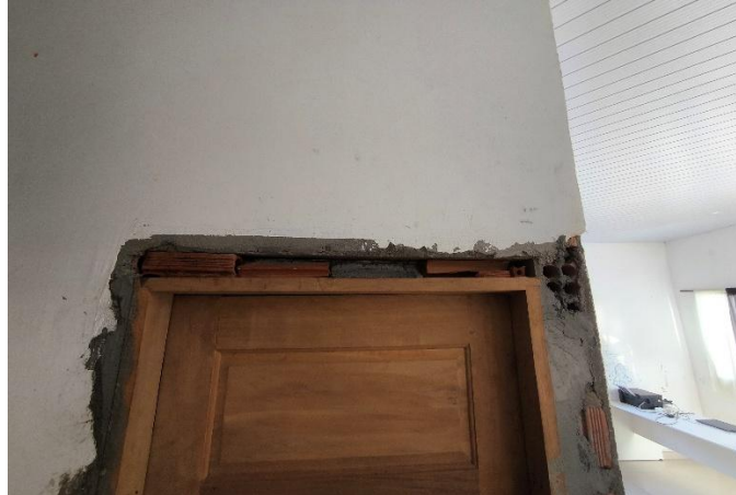
Figura 43 – Evidente ausência de verga na porta do quarto.
