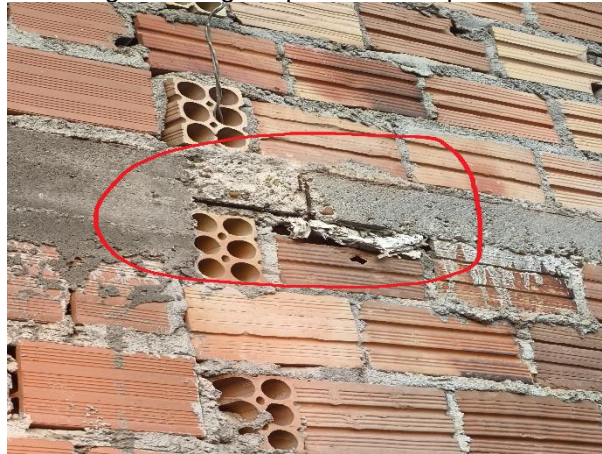
Figura 40 – Ferragem da viga exposta a intempéries na área externa.
