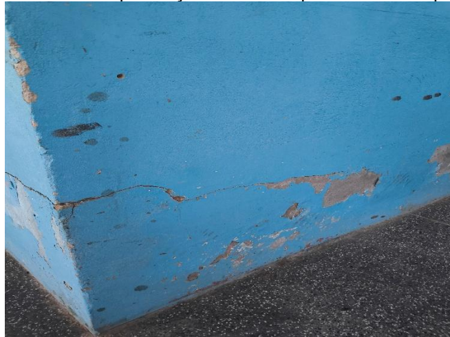
Figura 44 – Trinca horizontal e presença de umidade próxima ao rodapé da área externa.
