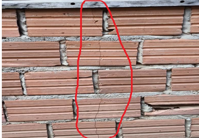
Figura 34 – Fissura no centro do vão da janela do quarto.
