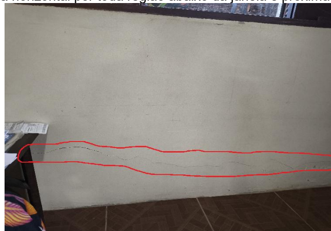
Figura 45 – Fissura horizontal por toda região abaixo da janela e próxima ao rodapé da sala.
