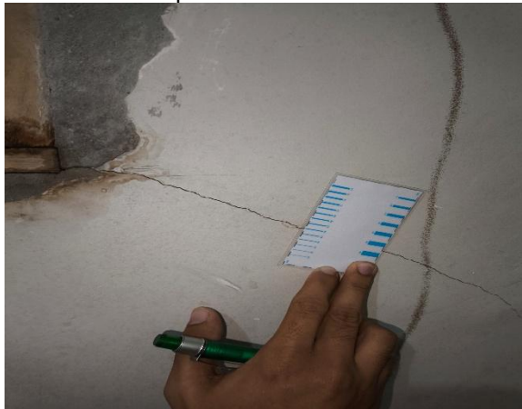
Figura 38 – Trinca de 0,6 mm partindo do vértice inferior da janela no quarto, em um ângulo aproximado de 45°.
