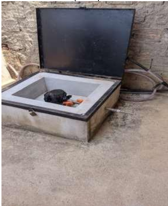
Figura 6 – Sistema de tubulação do ponto 04
