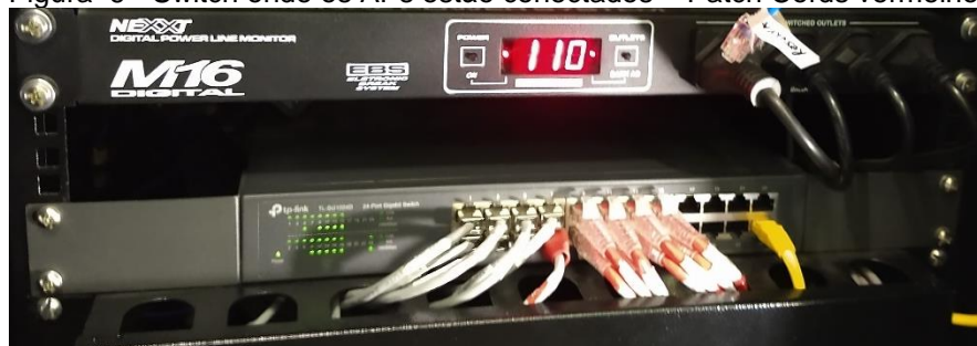
Figura 6 - Switch onde os APs estão conectados – Patch Cords vermelhos
