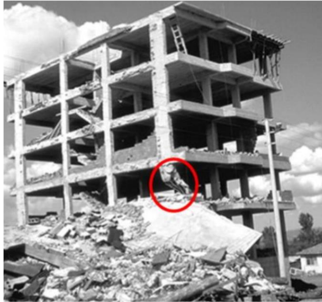
Figura 1.2 – Colapso de pilar por deformação plástica excessiva (Fonte: Zhao, 2011)
