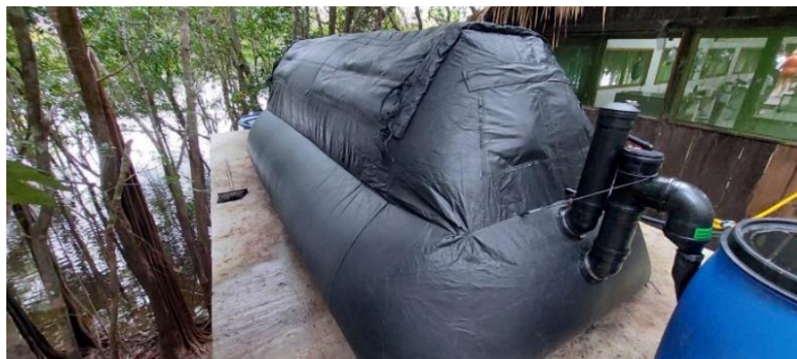
Figura 4 – Biodigestor instalado em ambiente amazônico, exemplar de tecnologia sustentável adaptável a comunidades isoladas.
