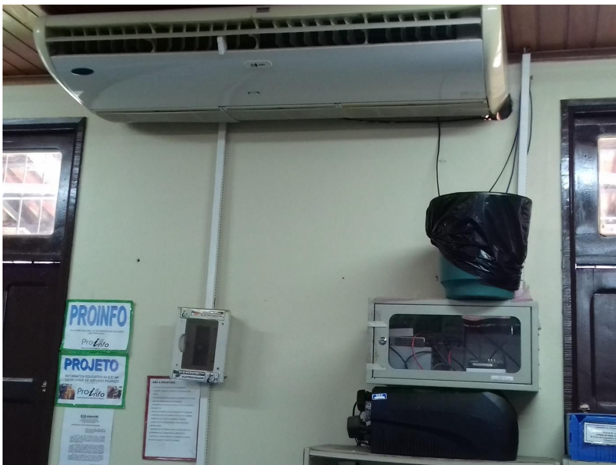
Figura 21 - Infraestrutura de entrada LIED.
