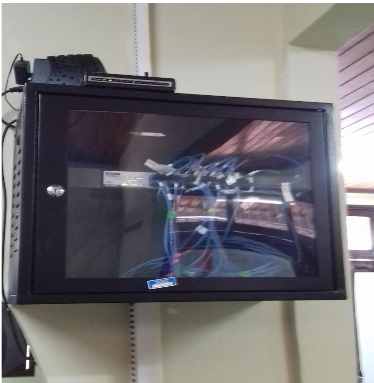
Figura 22 - Sala de equipamentos e telecomunicações LIED.
