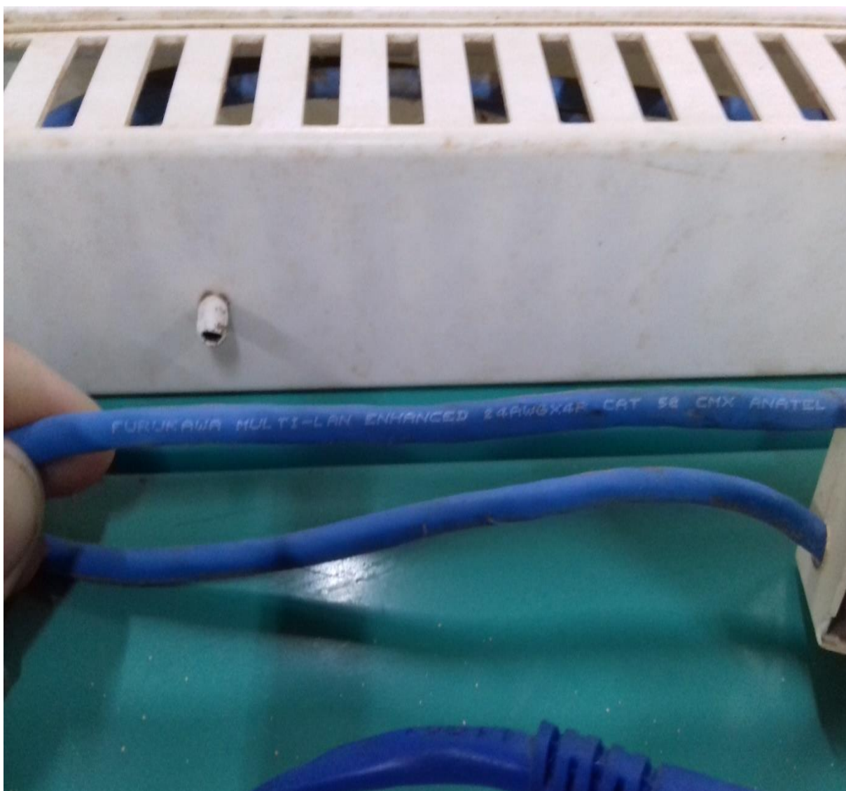
Figura 19 - Cabos de rede e Canaletas.
