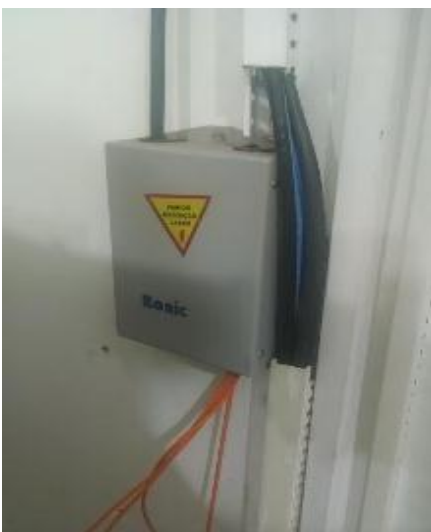
Figura 19 - Terminador óptico utilizado na transição entre o cabo óptico externo do PRODAP e a extensão óptica interna
