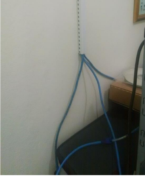
Figura 30 - Área de Trabalho com caixa de sobrepor ausente
