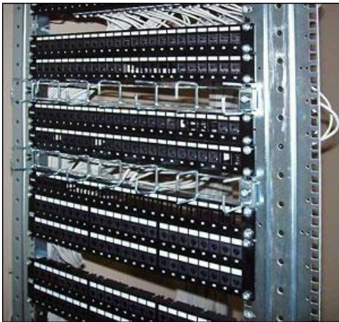
Figura 2 - Armário e Rack de Telecomunicações
