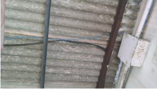
Figura 24 - Cabeamento Primário da CAESA
