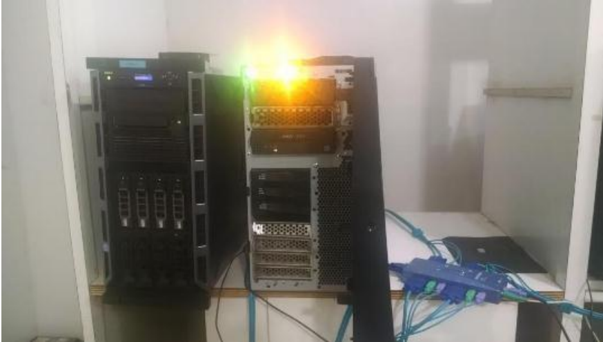
Figura 22 - Servidores Dell PowerEdge utilizados na Sala de Equipamentos
