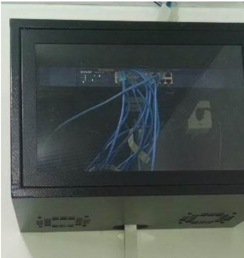
Figura 26 - Switch em Armário de Telecomunicação
