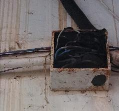
Figura 28 - Cabeamento Secundário exposto ao lado da fiação elétrica
