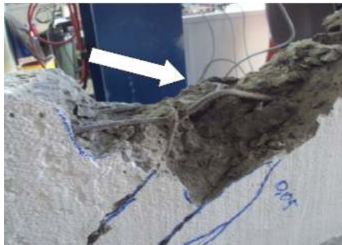
Figura 64 - Deslocamento da armadura de porta estribo da V02 (SILVA, 2012)
